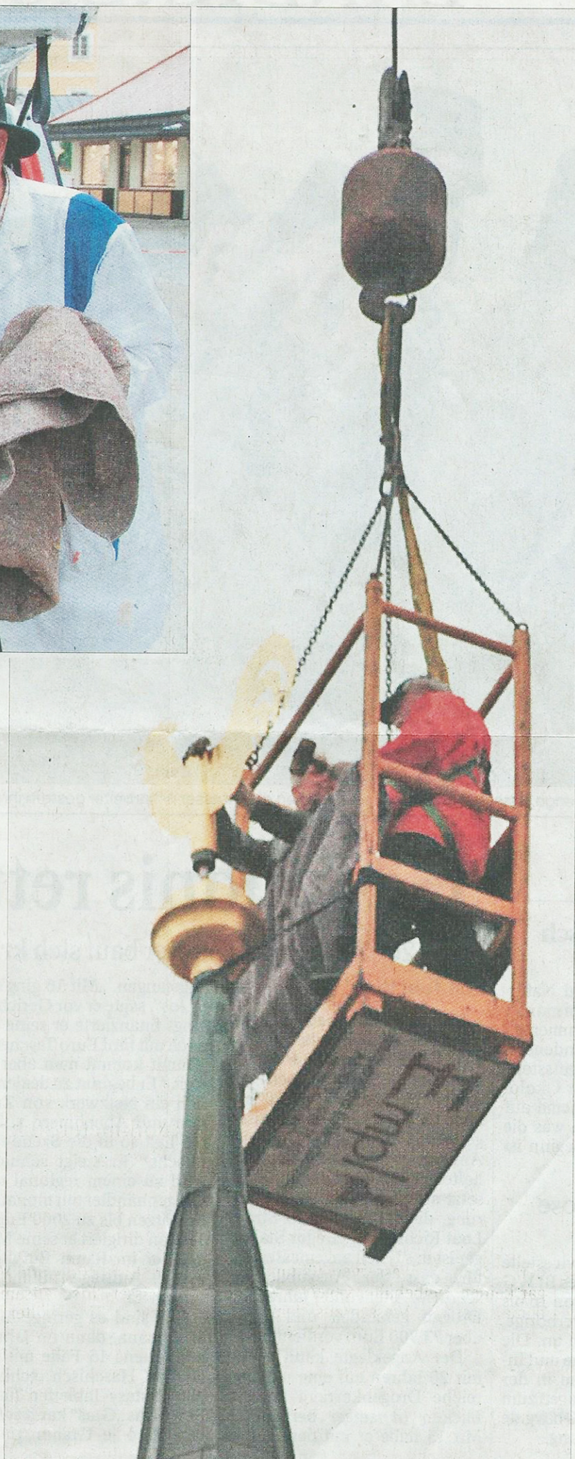
In luftiger Höhe von fast 70 Metern montierten Robert Empl und Hans Wache die Wetterhähne.
